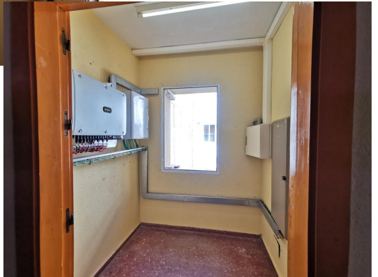
Inversor y Cuadro Eléctrico
